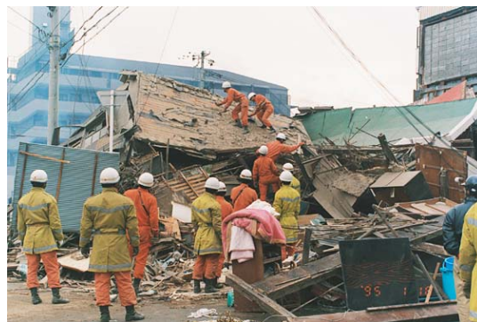
図1-2 阪神・淡路大震災での家の倒壊状況
