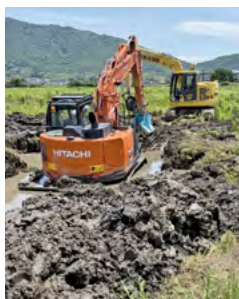
【水路にはまった重機】
