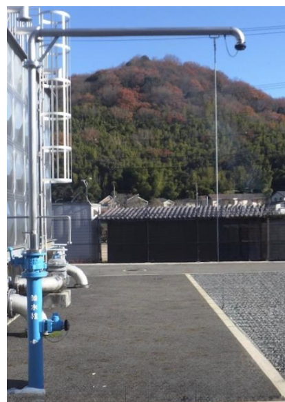
写真 2.6.5 岩倉応急給水栓
