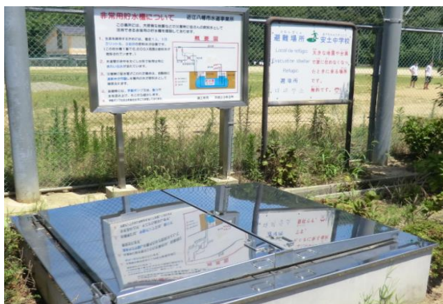
写真 2.6.14 安土町耐震性貯水槽
