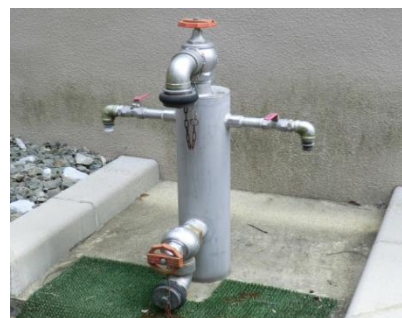
写真 2.6.12 応急給水設備
