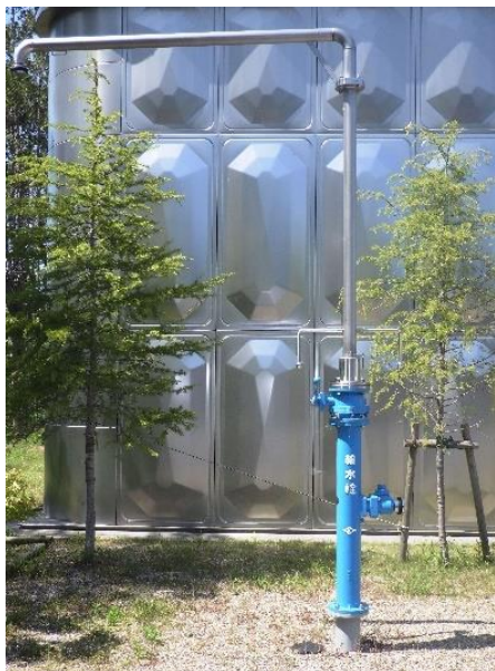
写真 2.6.7 牧応急給水栓
