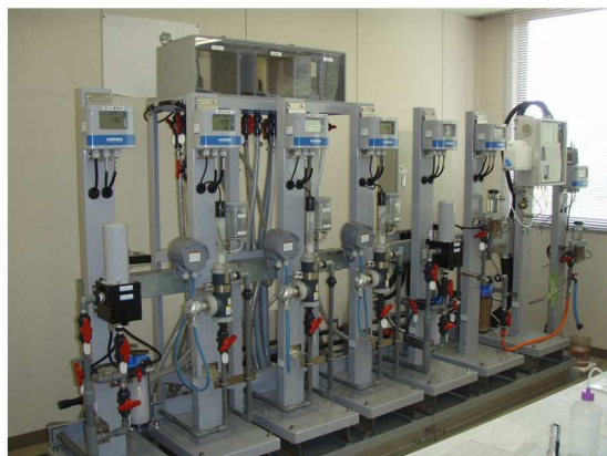
水質計器による日常監視
