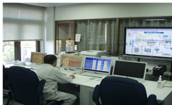
牧浄水場中央監視室
