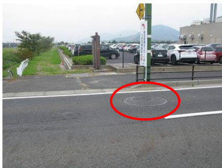
【マンホール ポンプ】
