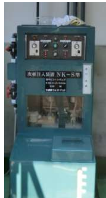
写真 2.5.19 塩素注入設備
