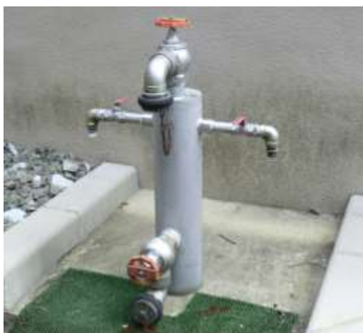
写真 2. 5. 44 非常用給水栓
