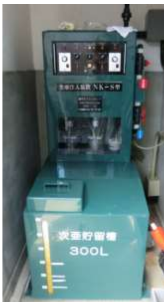
塩素注入設備
