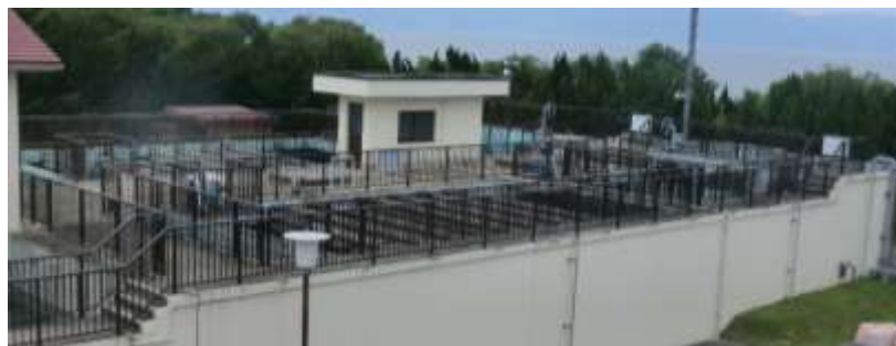
写真 2.5.2 フロック形成池・薬品沈殿池
