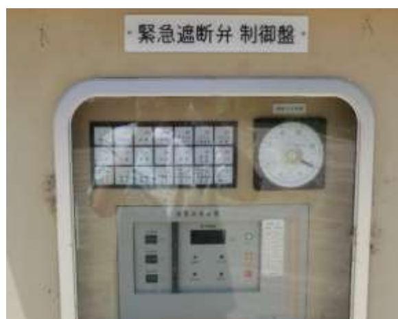
写真 2. 5. 45 緊急遮断弁の制御盤
