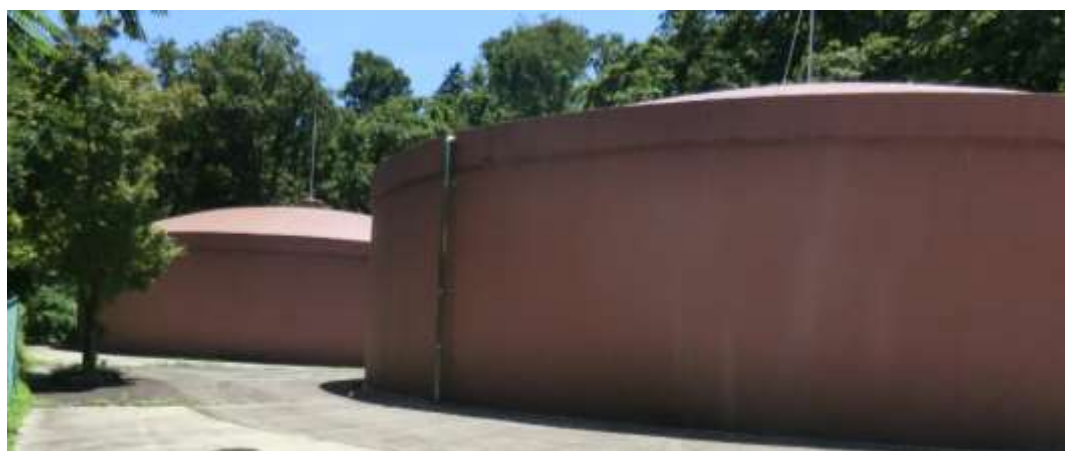
写真 2.5.37 長福寺配水池
