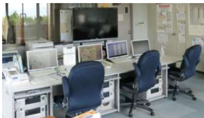
写真 2.6.4 牧浄水場の水質監視設備
