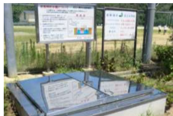
写真 2.5.48 安土町耐震性貯水槽
