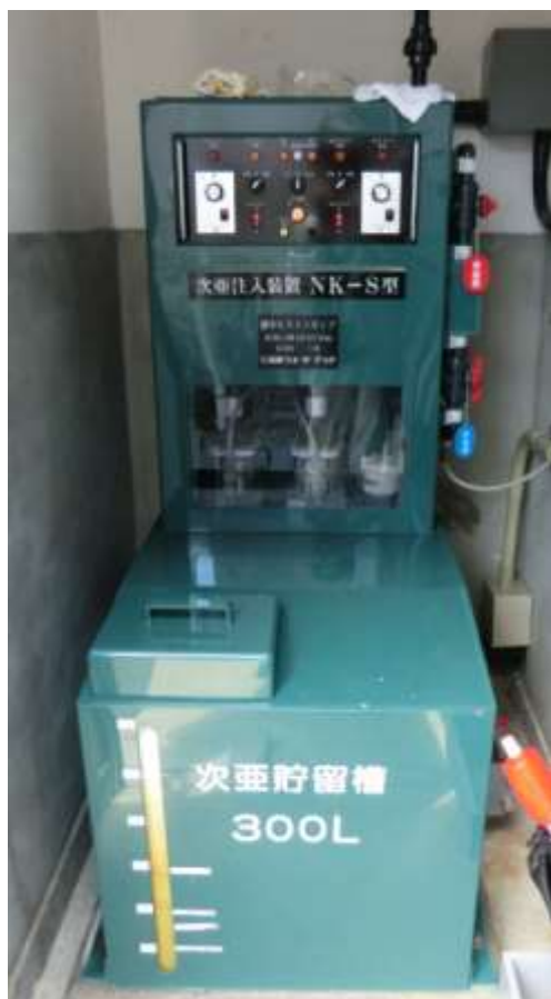
写真 2. 5. 13 塩素注入設備
