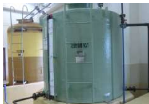
写真 2.5.5 PAC・次亜塩素酸ナトリウム貯留タンク
