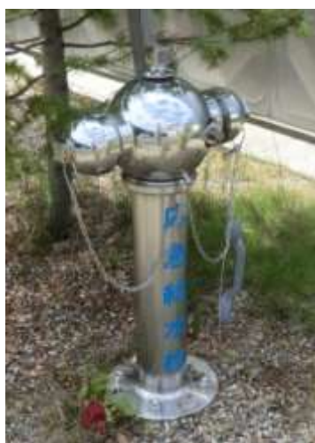
写真 2.5.34 牧応急給水栓
