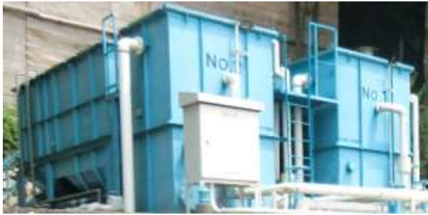
写真 2. 5. 24 急速ろ過設備
