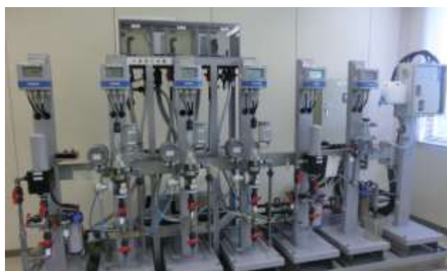
写真 2.6.1 水質計器による日常監視
