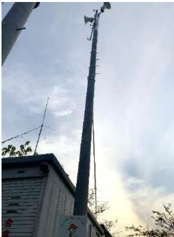
山の手自治会（放送設備）
