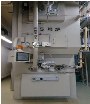
さざなみ浄苑火葬炉
