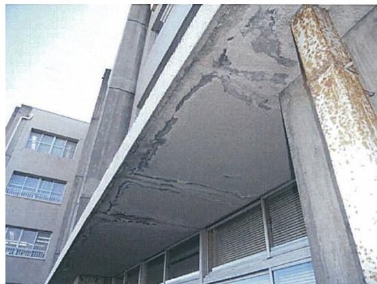
軒裏のクラック 14 と仕上の劣化（外部）
