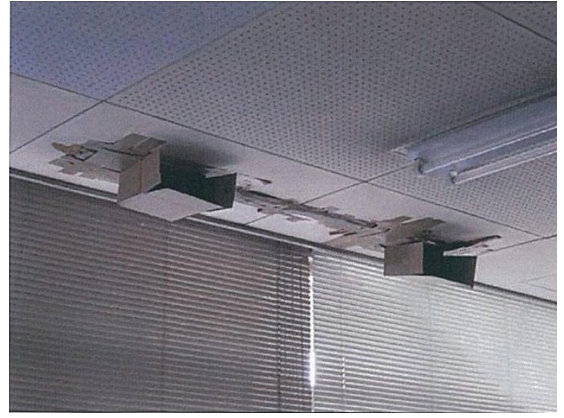
破損した空調吹出口
