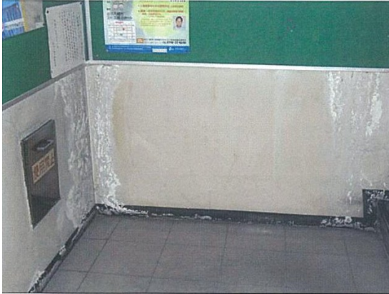
壁のクラックと漏水跡（3 階西階段室）
