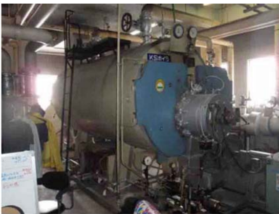
建設当時から使用している設備機器
