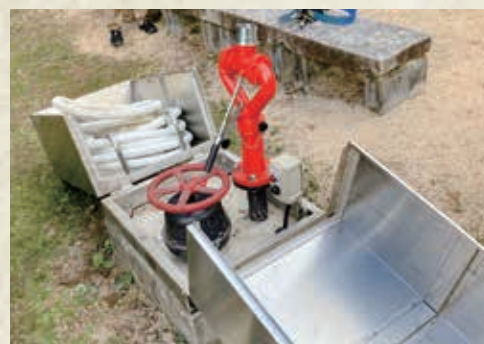
格納されている放水銃
