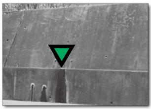
地下水の流出
