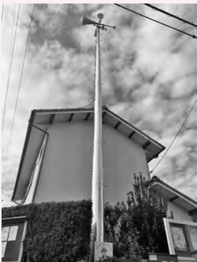
日吉野東自治会の放送設備
