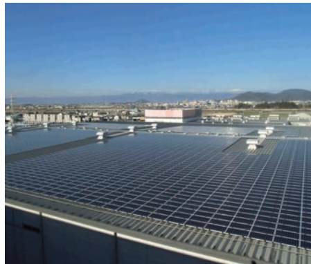
750kWの太陽光発電
